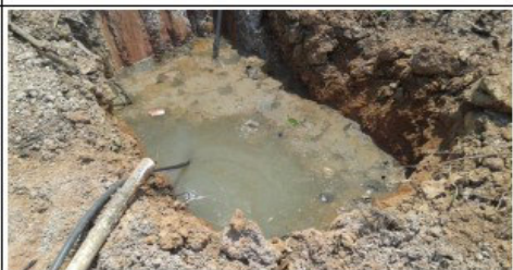
Poço que funciona como coletora de efluente líquido
