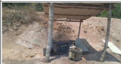
Pequeno gerador e vasilhame de combustível
