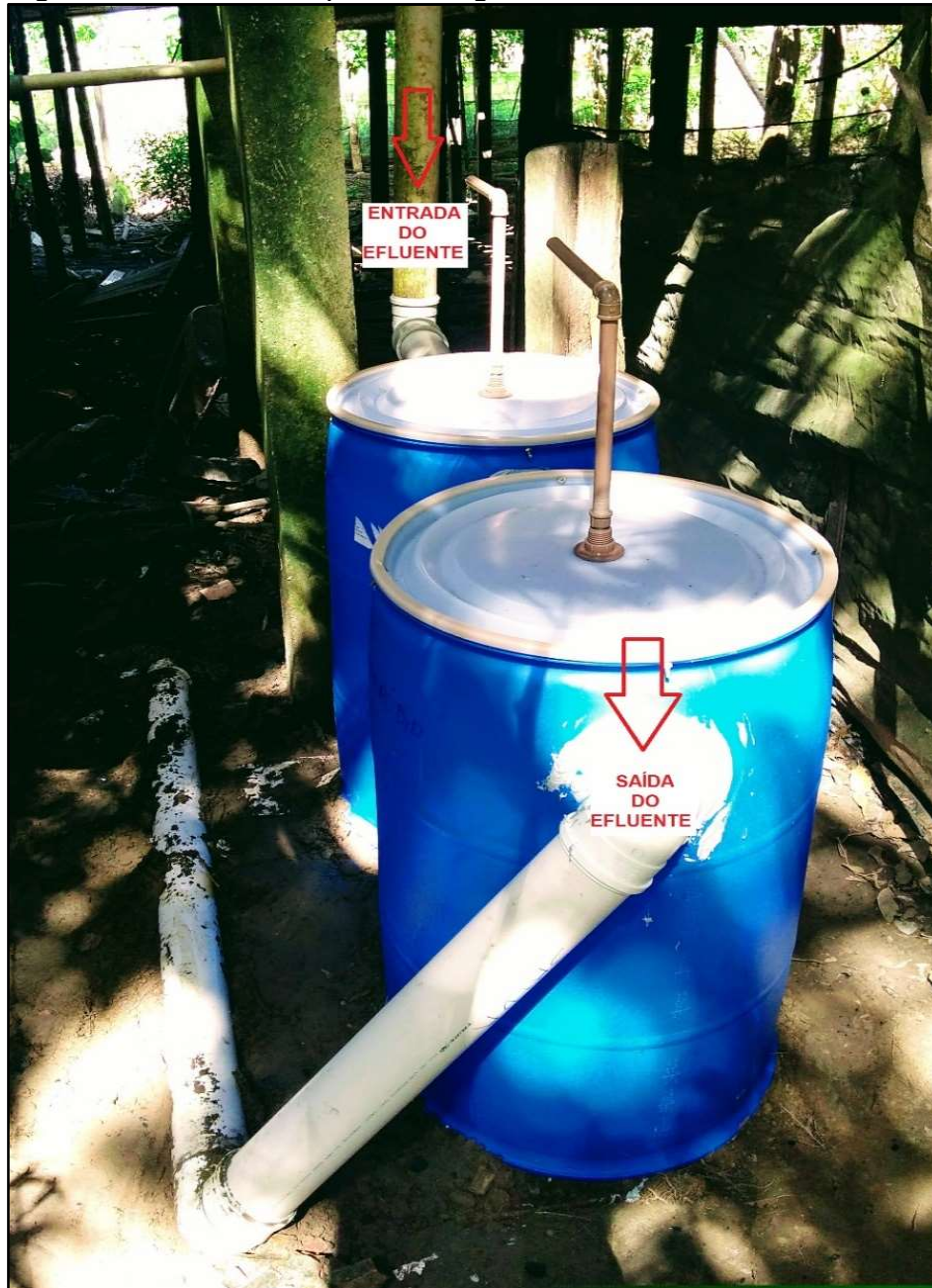
Figura 22 - Tambor Séptico Biodigestor instalado, Iranduba – AM.
