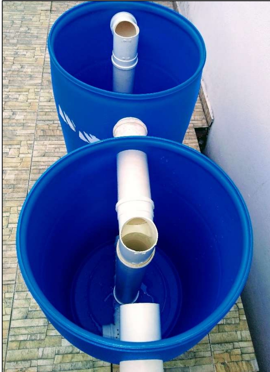
Figura 16 - Tubos e conexões do TSB, Manaus – AM.
