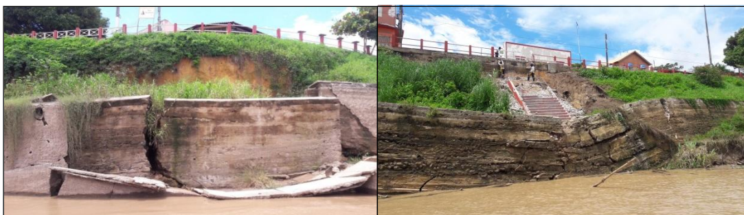
Figuras 6: Aspectos erosivos na área central da cidade
