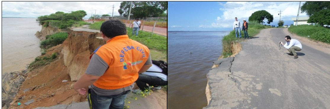
Figuras5: Aspectos erosivos na Rua Portugal
